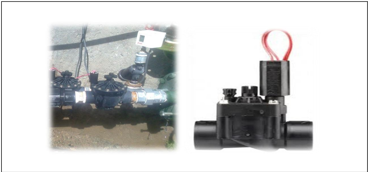
شکل ۴: نمایی از شیر برقی هوشمند اجرا شده در سازمان پارکها
